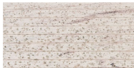
Stockflecken/Schimmel auf der Oberfläche
